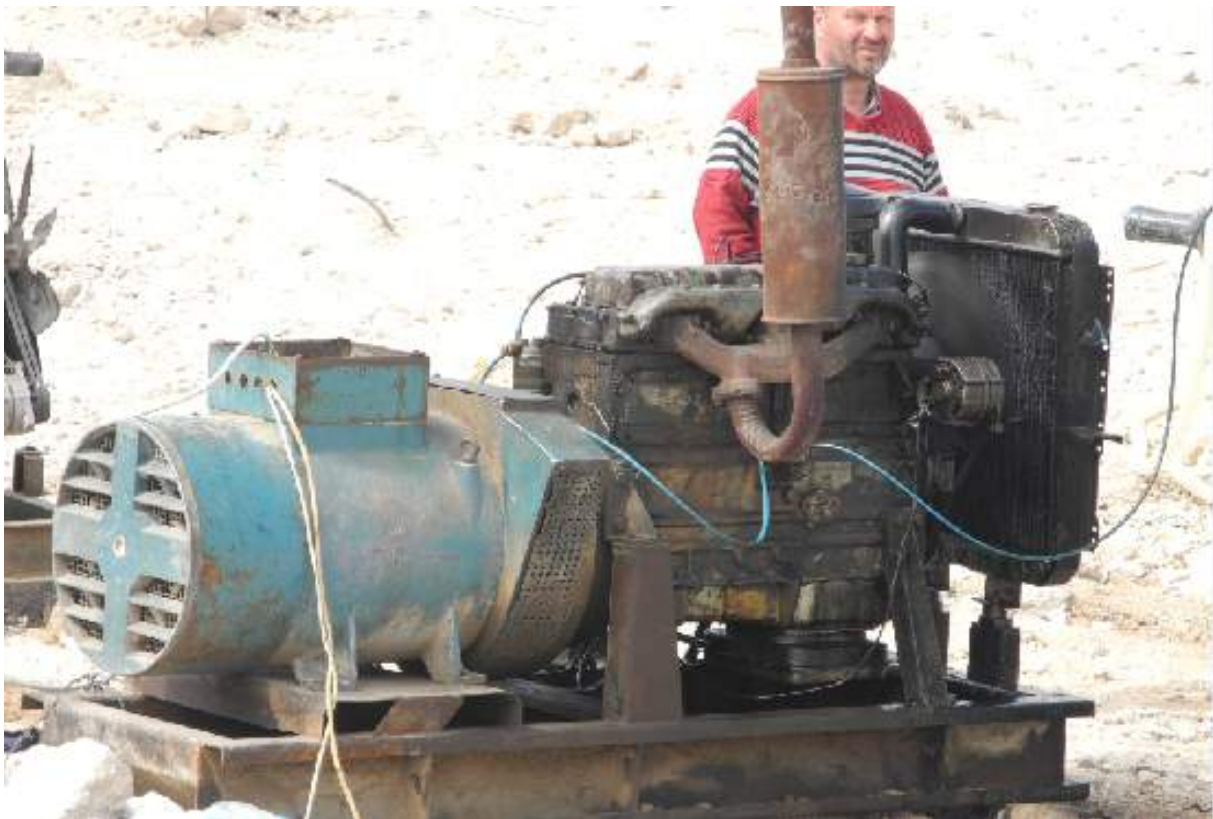
Stromversorgung durch Dieselgeneratoren
